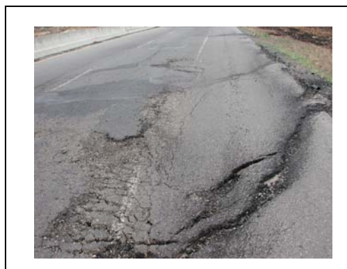
Fotografía N° 8 Detalle del corrimiento de la carpeta por mala inspección de la superficie del apoyo de la carpeta
